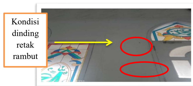
Gambar 4.8. Kondisi Dinding Masjid Al-Falah
