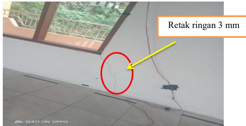
Gambar 4.21. Bagian Dinding Retak Susut Plastis
