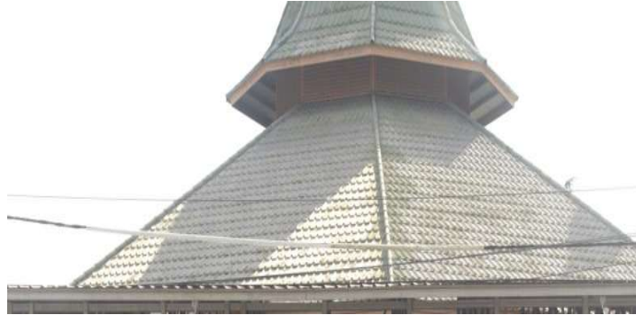
Gambar 4.7. Kondisi Atap Masjid Al-Falah
