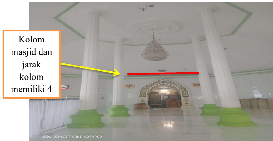
Gambar 4.10. Kondisi Kolom Masjid Al-Falah
