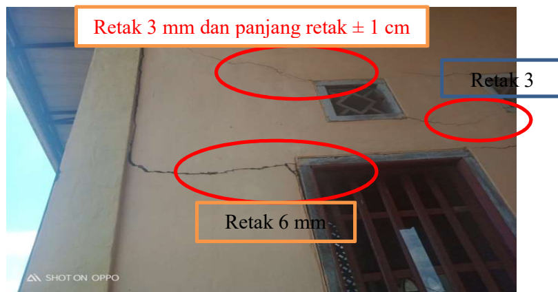
Gambar 4.14. Kondisi Dinding Masjid AL-Ikhlas
