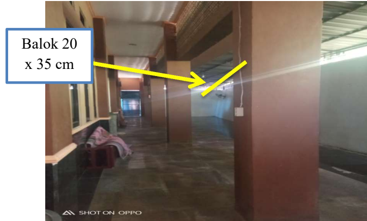
Gambar 4.3. Kondisi Balok Masjid Al-Muhajirin
