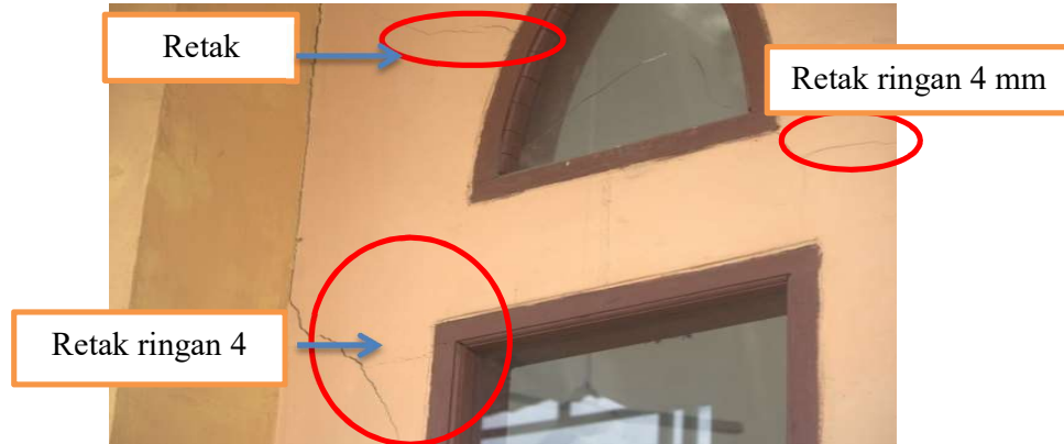
Gambar 4.20. Retak Tekan Dinding
