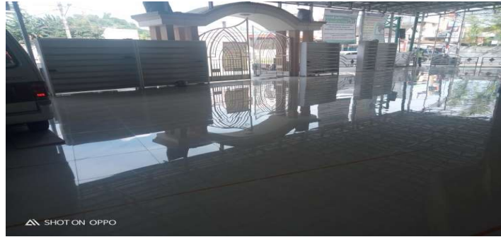
Gambar 4.11. Kondisi Lantai Masjid Al-falah
