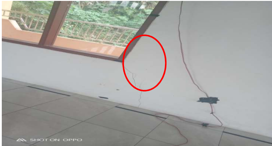
Gambar 24. Kondisi dinding lantai 2 arah Timur
