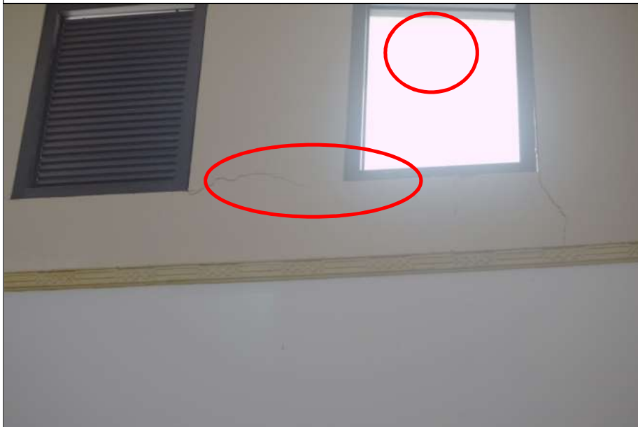
Gambar 26. Penampang dinding masjid Kondisi pada bagian dinding kubah masjid di arah Utara memiliki retak parah pada bagian kusen atas dan panjang retak mencapai 50 cm.
