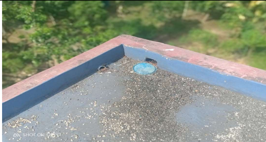
Gambar 9. Tampak dak pembuangan air
