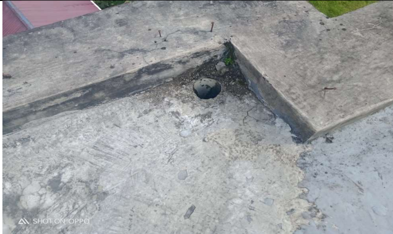
Gambar 8. Tampak dak pembuangan air
