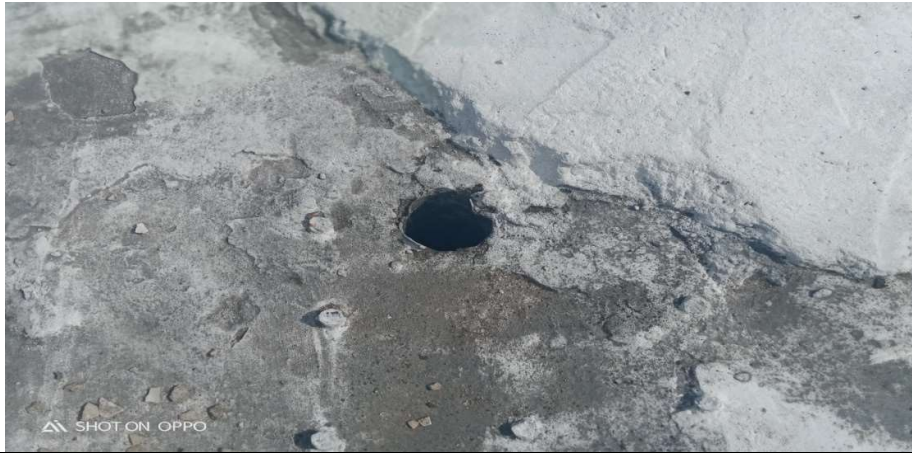
Gambar 11. Tampak dak pembuangan air
