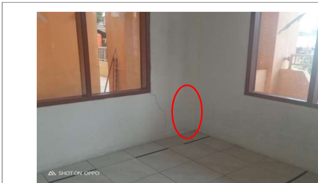
Gambar 21. Kondisi dinding lantai 2 arah Selatan
