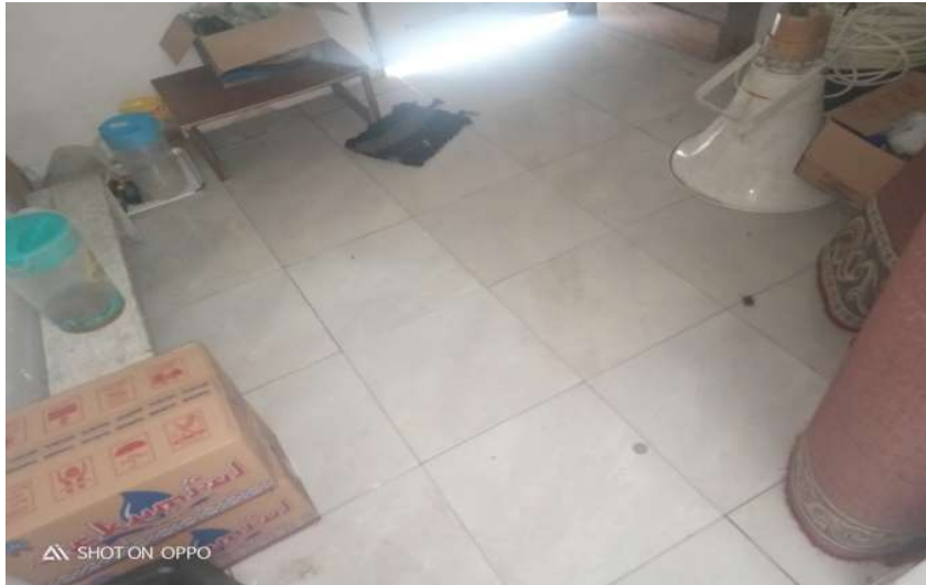
Gambar 36. Kondisi lantai gudang masjid
