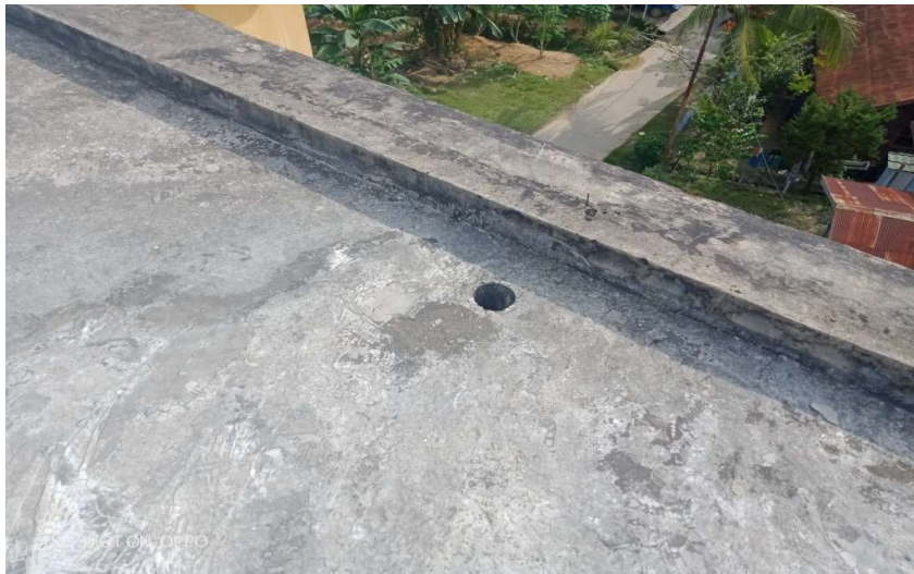
Gambar 9. Tampak dak pembuangan air
