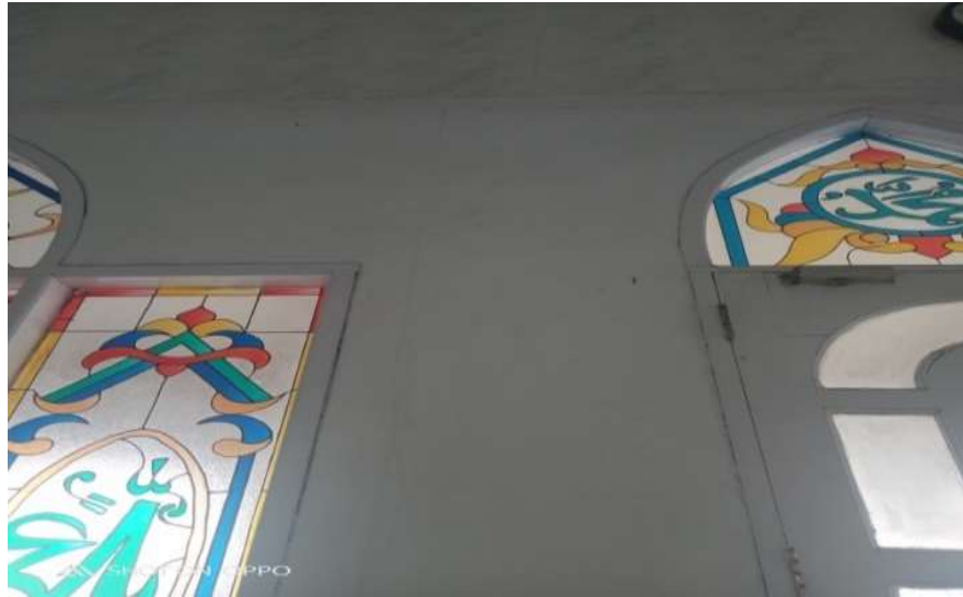
Gambar 6. Kondisi dinding arah Timur
