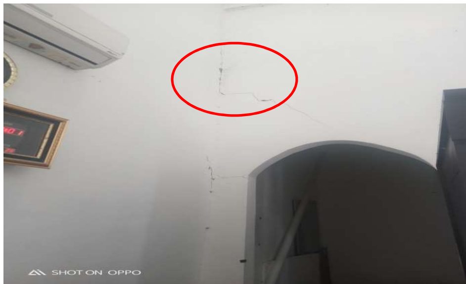
Gambar 33. Kondisi dinding masjid belakang mimbar
