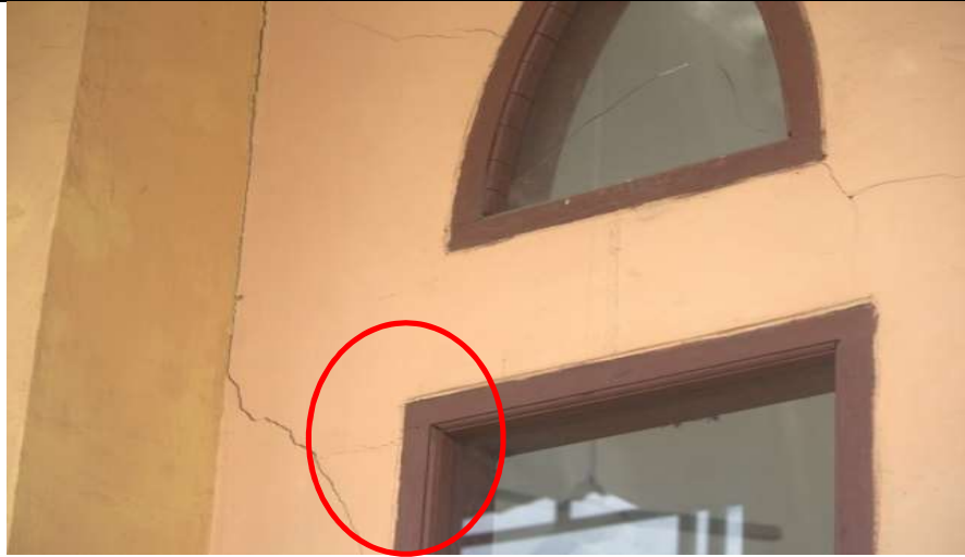
Gambar 26. Kondisi dinding arah selatan
