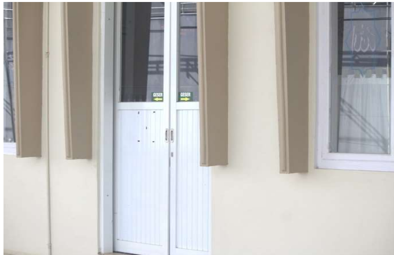
Gambar 9. Kondisi dinding arah Selatan Kondisi dinding arah Selatan yang tidak memiliki retakan ringan atau sedang
