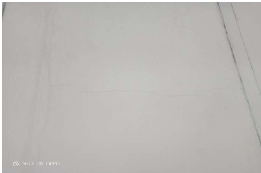
Gambar 7. Kondisi dinding arah Timur
