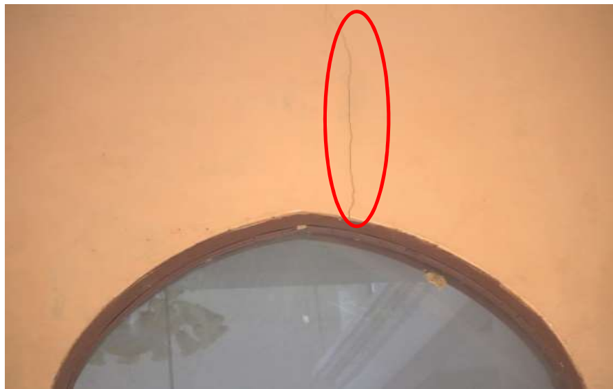
Gambar 27. Kondisi dinding arah Selatan
