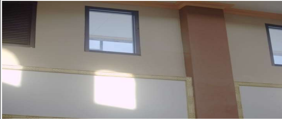
Gambar 25. Penampang dinding masjid arah Timur Kondisi bagian arah Timur pada bagian dudukan kubah masjid mengalami retak rambut.
