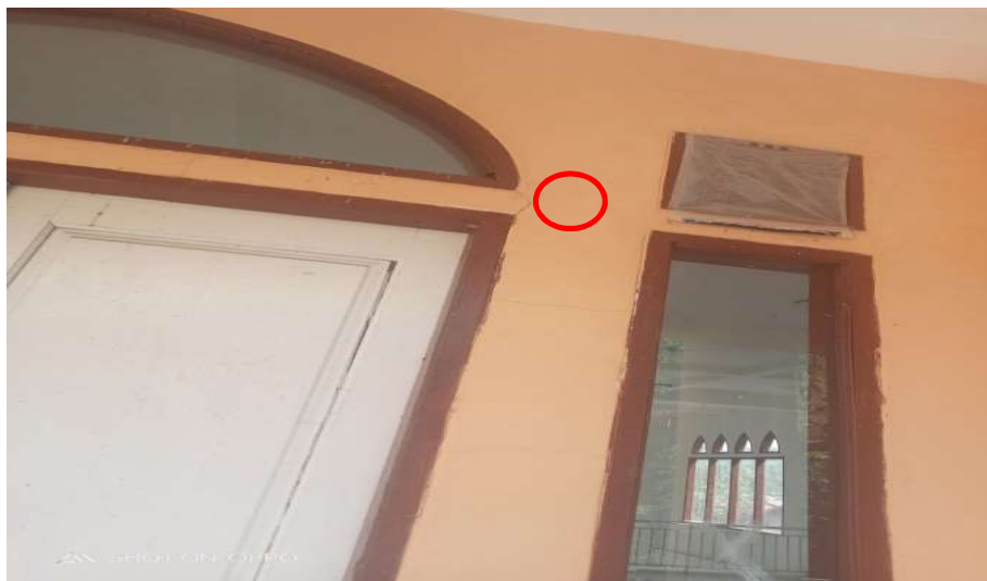
Gambar 30. Kondisi dinding arah Timur
