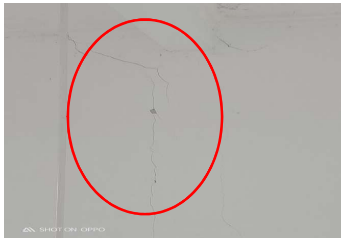
Gambar 23. Kondisi dinding arah Barat lantai 2
