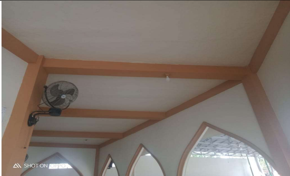
Gambar 12. Kondisi balok arah Utara
