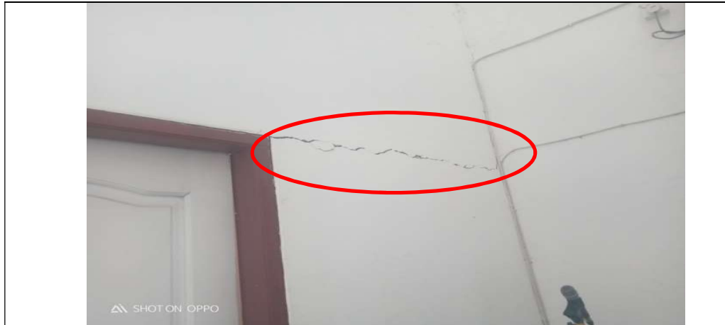
Gambar 32. Kondisi dinding samping mimbar
