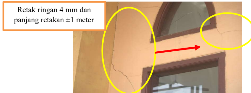
Gambar 10 : Retak Tekan Dinding
