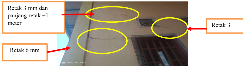
Gambar 4 : Kondisi dinding masjid AL-Ikhlas
