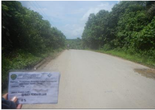
Kondisi Ruas Jalan Semoi Sepaku Petung 1 STA 17+225.
