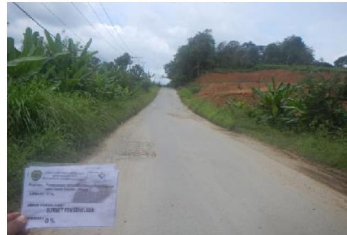
Kondisi Ruas Jalan Semoi Sepaku Petung 1 STA 18+650.
