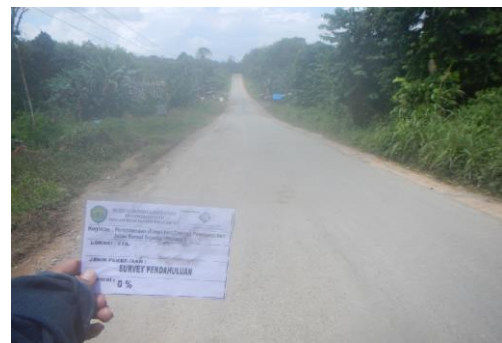
Kondisi Ruas Jalan Semoi Sepaku Petung 1 STA 17+425.
