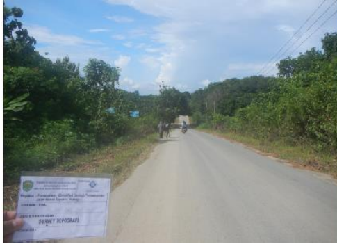
Kondisi Ruas Jalan Semoi Sepaku Petung 1 STA 18+825.
