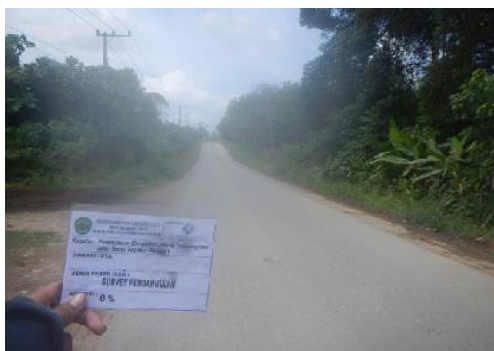
Kondisi Ruas Jalan Semoi Sepaku Petung 1 STA 17+550.
