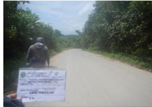
Kondisi Ruas Jalan Semoi Sepaku Petung 1 STA 17+250.
