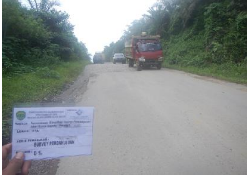
Kondisi Ruas Jalan Semoi Sepaku Petung 1 STA 17+100.
