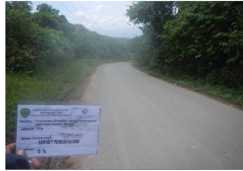
Kondisi Ruas Jalan Semoi Sepaku Petung 1 STA 16+675.
