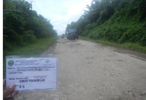
Kondisi Ruas Jalan Semoi Sepaku Petung 1 STA 17+125.
