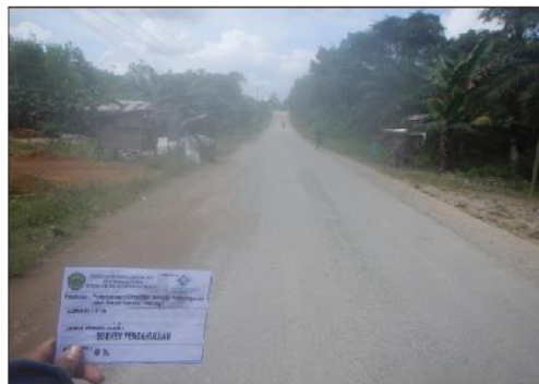
Kondisi Ruas Jalan Semoi Sepaku Petung 1 STA 17+500.
