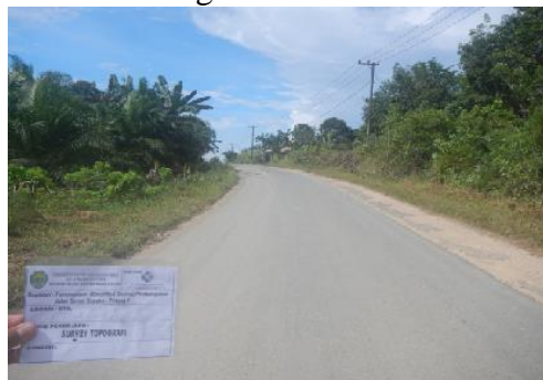
Kondisi Ruas Jalan Semoi Sepaku Petung 1 STA 18+995.
