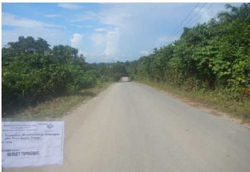
Kondisi Ruas Jalan Semoi Sepaku Petung 1 STA 18+775.
