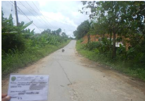
Kondisi Ruas Jalan Semoi Sepaku Petung 1 STA 18+625.
