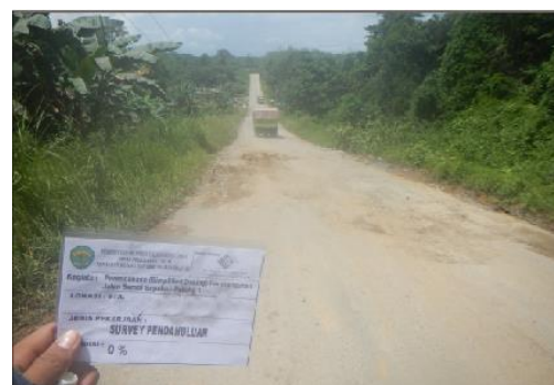
Kondisi Ruas Jalan Semoi Sepaku Petung 1 STA 17+375.
