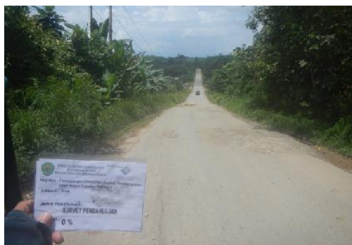
Kondisi Ruas Jalan Semoi Sepaku Petung 1 STA 17+350.
