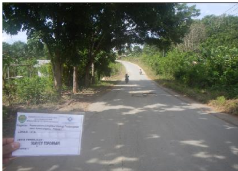
Kondisi Ruas Jalan Semoi Sepaku Petung 1 STA 18+950.
