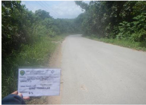
Kondisi Ruas Jalan Semoi Sepaku Petung 1 STA 16+650.
