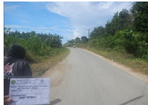
Kondisi Ruas Jalan Semoi Sepaku Petung 1 STA 18+975.
