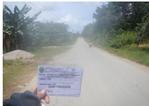
Kondisi Ruas Jalan Semoi Sepaku Petung 1 STA 17+525.
