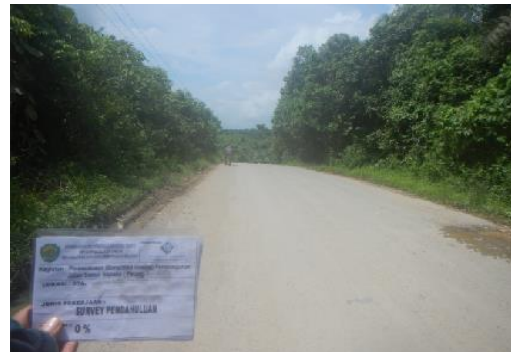
Kondisi Ruas Jalan Semoi Sepaku Petung 1 STA 17+175.
