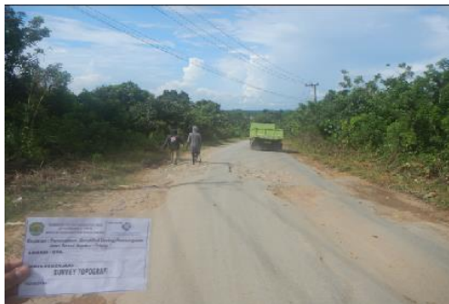
Kondisi Ruas Jalan Semoi Sepaku Petung 1 STA 18+725.
