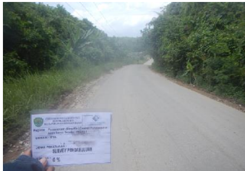
Kondisi Ruas Jalan Semoi Sepaku Petung 1 STA 17+300.
