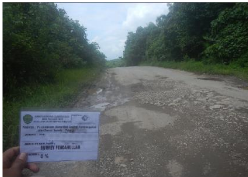
Kondisi Ruas Jalan Semoi Sepaku Petung 1 STA 17+150.
