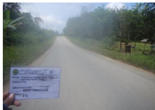
Kondisi Ruas Jalan Semoi Sepaku Petung 1 STA 17+575.
