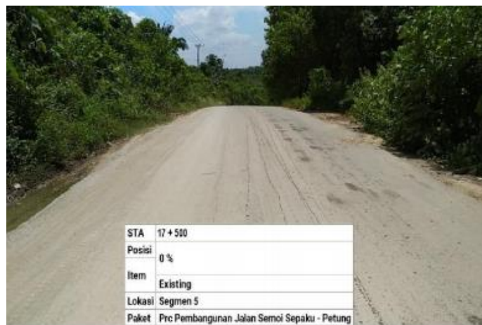
( Kondisi Ruas Jalan Semoi Sepaku STA 17+500 )
