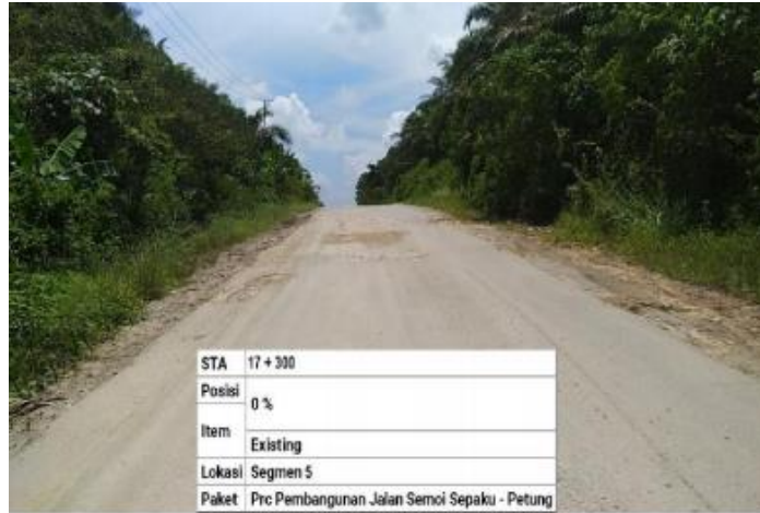
( Kondisi Ruas Jalan Semoi Sepaku STA 17+300 )
