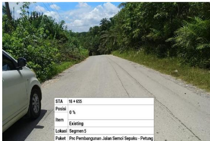
( Kondisi Ruas Jalan Semoi Sepaku STA 16 +665 )
