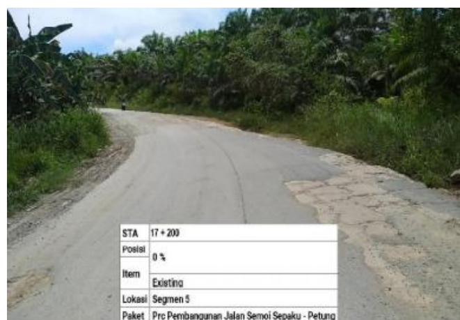
( Kondisi Ruas Jalan Semoi Sepaku STA 17+200 )
