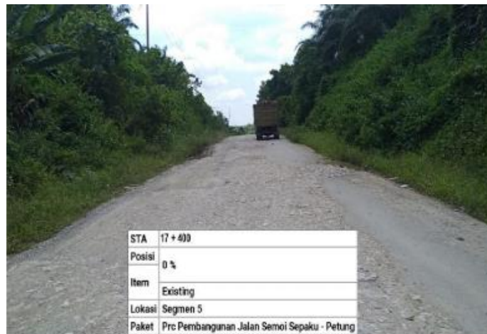
( Kondisi Ruas Jalan Semoi Sepaku STA 17+400 )
