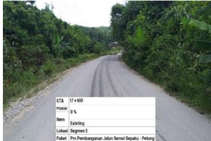
( Kondisi Ruas Jalan Semoi Sepaku STA 17+600 )
