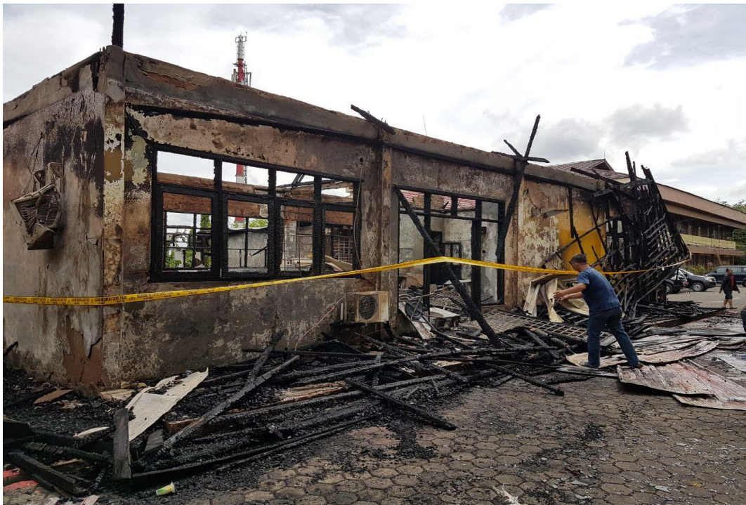
Kondisi Saat Kebakaran
