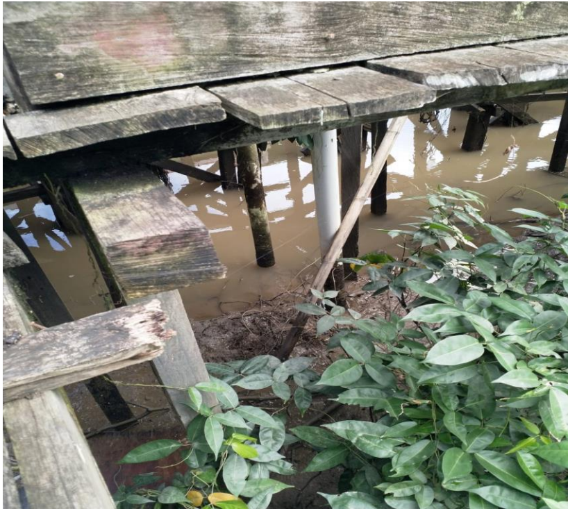
Gambar 7. Bukti Bahwa Pipa pembuangan Tinja di alirkan ke sungai
