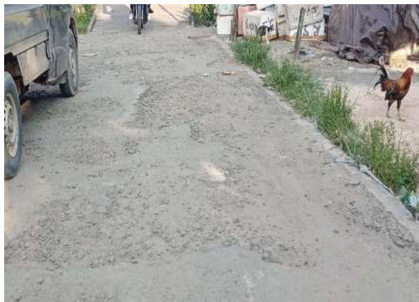
Gambar 1.3 Perkerasan Mengalami Korosi Akibat Genangan Air Laut. (Sumber: Dokumentasi Pribadi, 2023).
