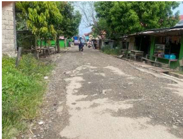
Gambar 1.2 Jalan Hj. Junudi Yang Mengalami Genangan Air Laut. (Sumber: Dokumentasi Pribadi, 2023)
