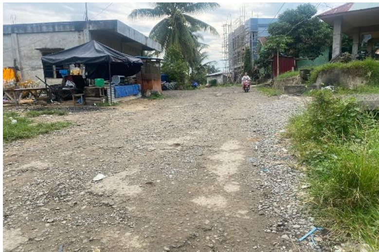
Gambar 1. 3 Kerusakan Jalan (Sumber : Dokumentasi pribadi 2023)
