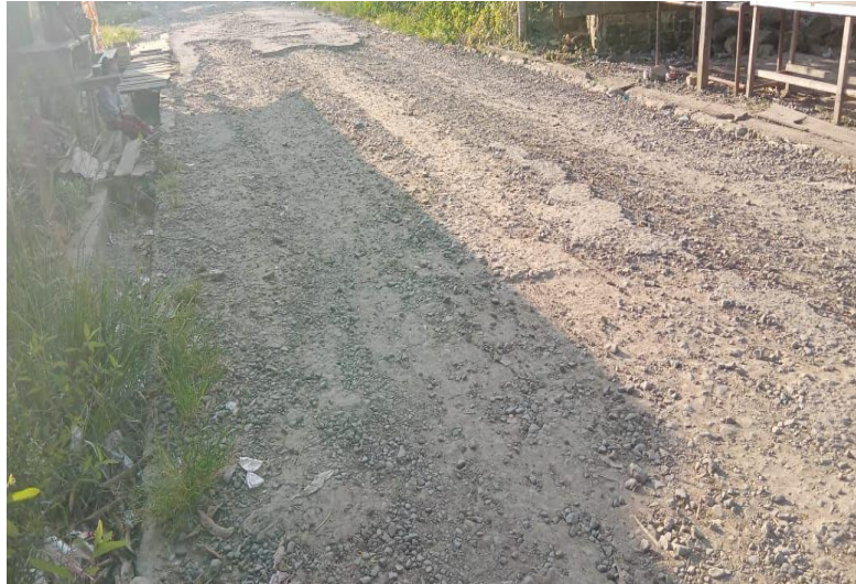
Gambar 1. 2 Kerusakan Jalan (Sumber : Dokumentasi pribadi 2023)
