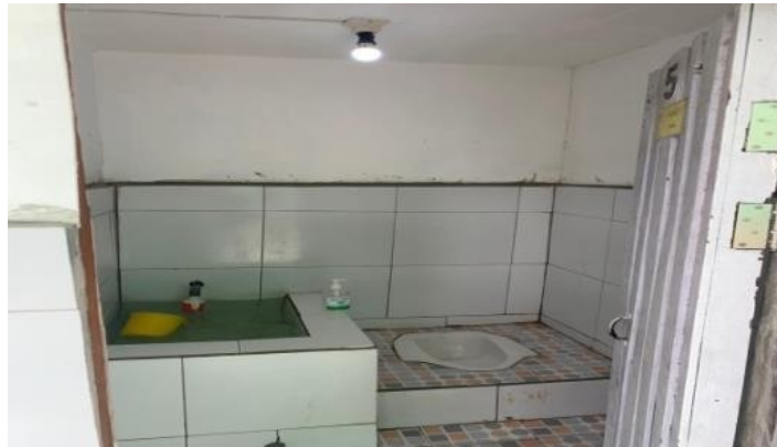
Gambar 4. 1 sumber : Toilet SD Muhammadiyah yang keadaan bersih dan tidak ada gendangan air (pribadi)
